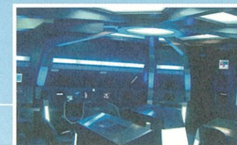
耗資台幣一億八千萬的台北機房。
